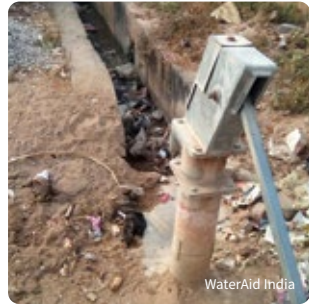
壊れて使えなくなった手押しポンプ式井戸(インド)
