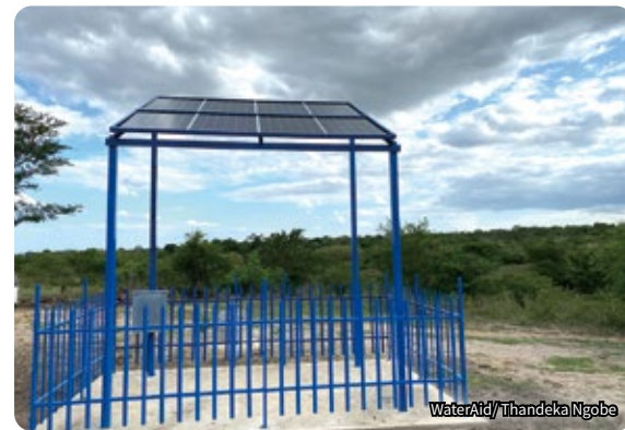
設置したソーラーパネル
