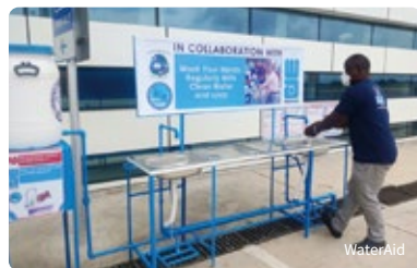
WaterAid 空港に設置した手洗い設備
