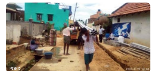
村水衛生委員会と住民が参加するワークショップで 作成した計画に沿って給水設備を設置・修復
