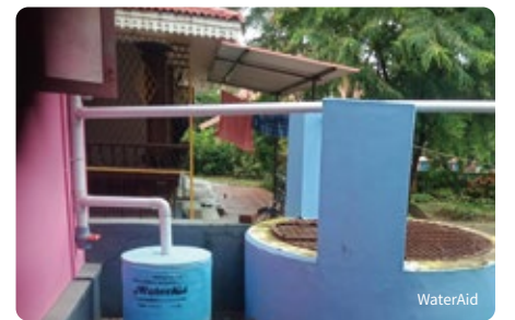
雨水タンク兼地下水涵養設備(インド)
