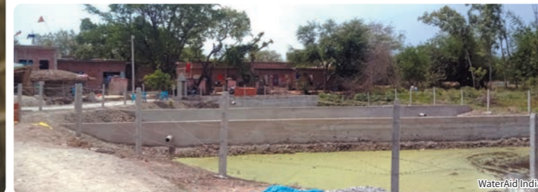
汚水処理システム(ウッタル・プラデシュ州ウナオ県)
